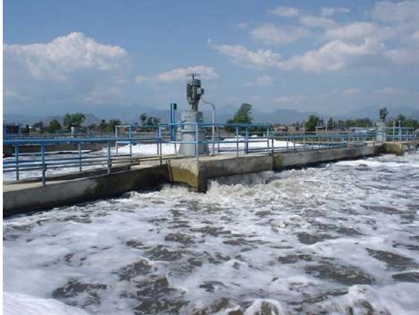
Figura 28. Foto de Planta de Tratamiento de Aguas Residuales.
