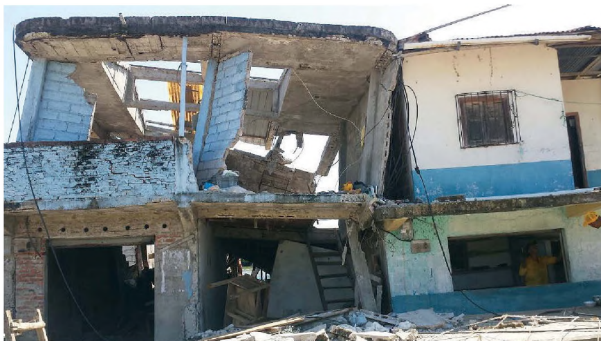
Figura 5.5.15 Edificación fuera de aplomo. Terremoto de Pedernales, Ecuador 2016.
