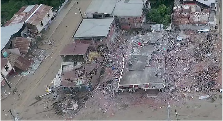
Figura 5.5.7 Colapso total de las estructuras. Jama, Ecuador 2016.
