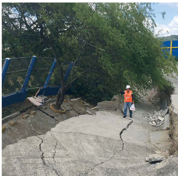
Figura 5.5.34 Colapso en veredas producto del movimiento del suelo. Manabí, Ecuador, 2016
