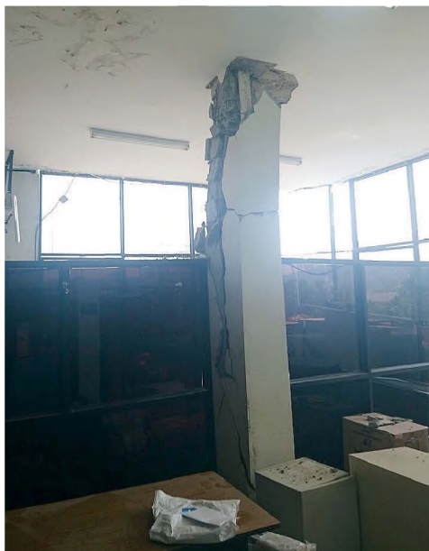
Figura 5.5.19 Daños severos en columna interna. Terremoto de Pedernales, Ecuador 2016.
