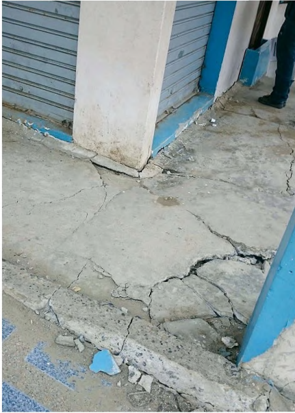
a) Hundimiento de columna
