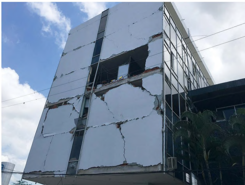
Figura 5.5.22 Grietas grandes en paredes u otros daños severos. Señalizar Inseguro. Terremoto de Pedernales, Ecuador 2016.
