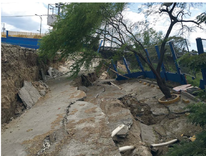
Figura 5.5.32 Movimiento considerable del suelo. Manabí, Ecuador, 2016
