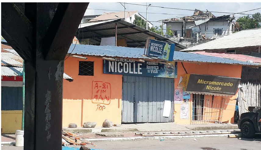
Figura 5.5.23 Grietas grandes en paredes u otros daños severos, pared a punto de caer. Señalizar Inseguro. Terremoto de Pedernales, Ecuador 2016.
