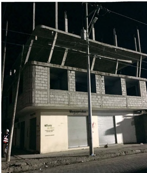
Figura 5.5.14 Edificación fuera de aplomo. Terremoto de Pedernales, Ecuador 2016.
