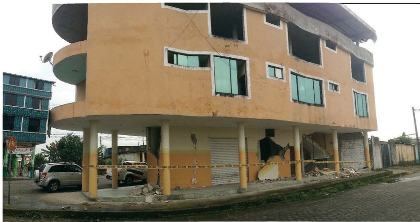
Figura 5.5.24 Revestimientos y mamposterías amenazan caer. El Carmen, Manabí, Ecuador 2016.
