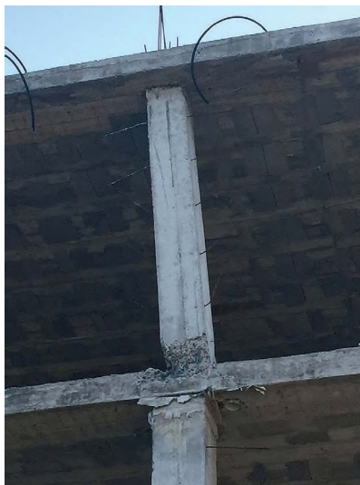
Figura 5.5.16 Edificación fuera de aplomo. Terremoto de Pedernales, Ecuador 2016.
