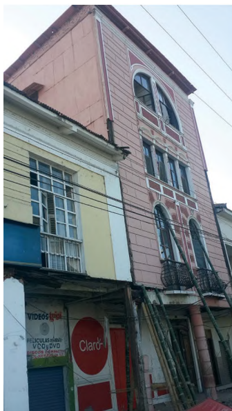
Figura 5.5.17 Edificación fuera de aplomo, se puede observar apuntalamiento por seguridad. Bahía, Ecuador 2016.
