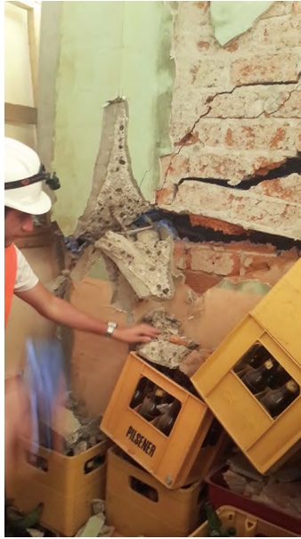
Figura 5.5.20 Daño severo en columnas, grietas grandes en pared de ladrillo. Terremoto de Pedernales, Ecuador 2016.
