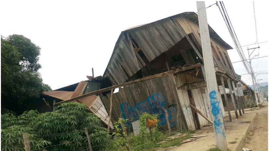
Figura 5.5.8 Colapso parcial de la estructura. Jama, Ecuador 2016.
