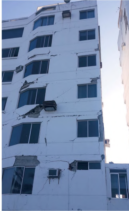
Figura 5.5.26 Fisuras severas en mampostería, amenaza caer. Bahía, Ecuador 2016.
