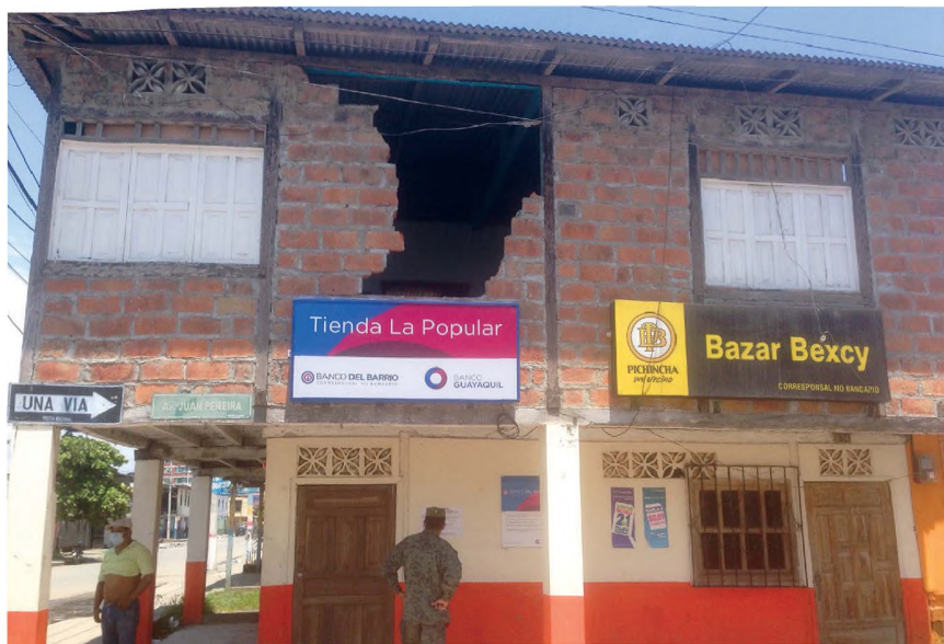
Figura 5.5.25 Revestimientos y mamposterías amenazan caer. Pedernales, Manabí, Ecuador 2016.
