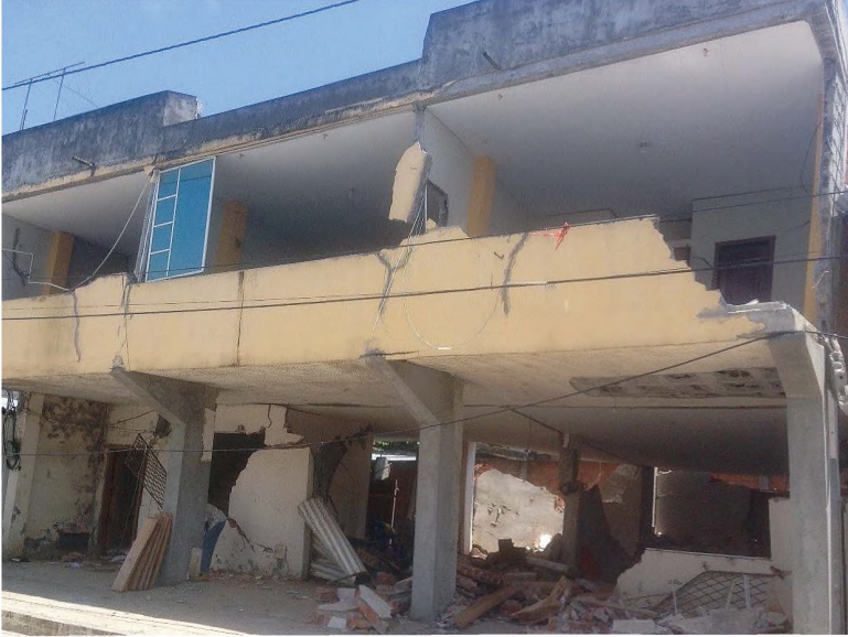
Figura 5.5.1 Vista externa de una estructura. Terremoto de Pedernales, Ecuador 2016.
