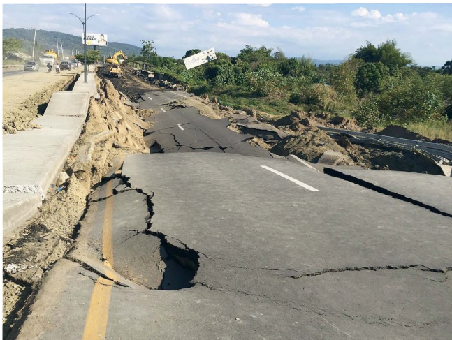
Figura 5.5.31 Hundimiento de la calzada producido por movimiento del suelo. Manabí, Ecuador, 2016
