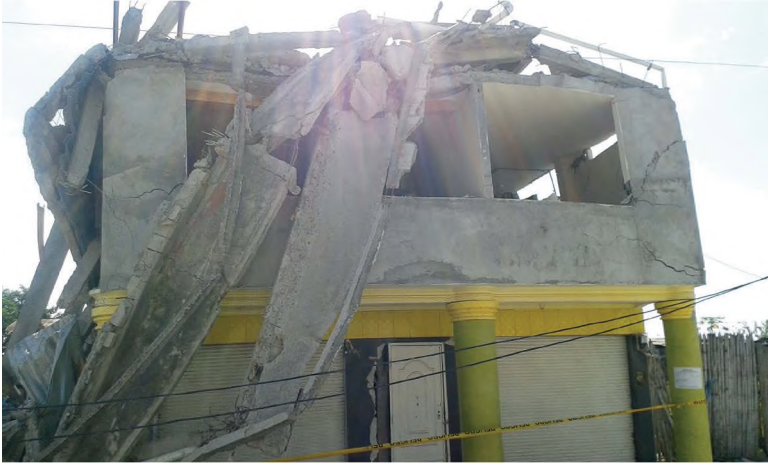
Figura 5.5.10 Colapso total de la estructura. Terremoto de Pedernales, Ecuador 2016.
