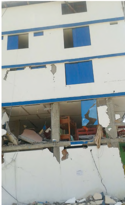
Figura 5.5.29 Revestimientos y escombros amenazan caer. Bahía, Manabí, Ecuador 2016.
