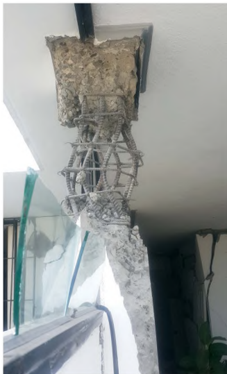
Figura 5.5.21 Daño severo en columnas, efecto de torsión. Terremoto de Pedernales, Ecuador 2016.
