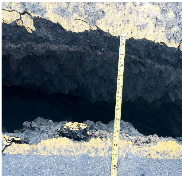
Figura 5.5.33 Separación de la calzada por movimiento de suelos. Manabí, Ecuador, 2016
