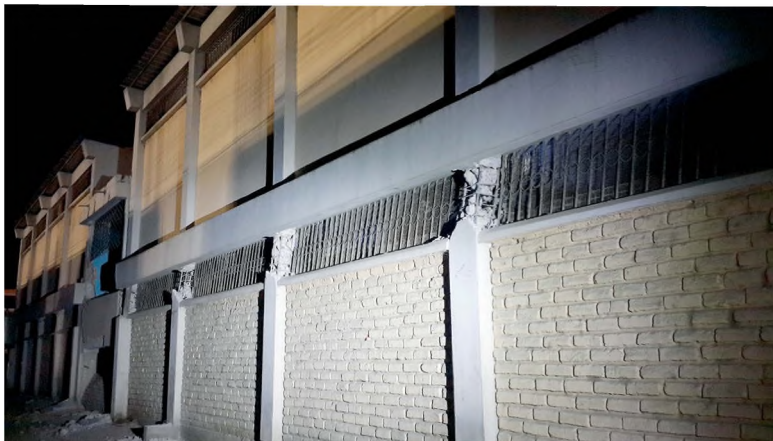
Figura 5.5.18 Daños severos en columna, explosión del hormigón. Terremoto de Pedernales, Ecuador 2016.
