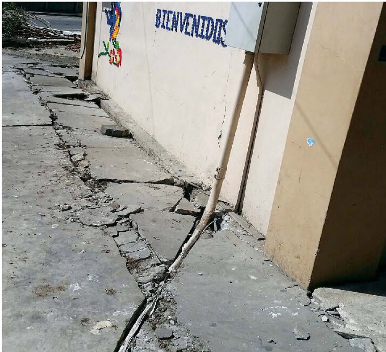
Figura 5.5.11 Cimentación afectada por problemas geotécnicos. Manta, Ecuador 2016.
