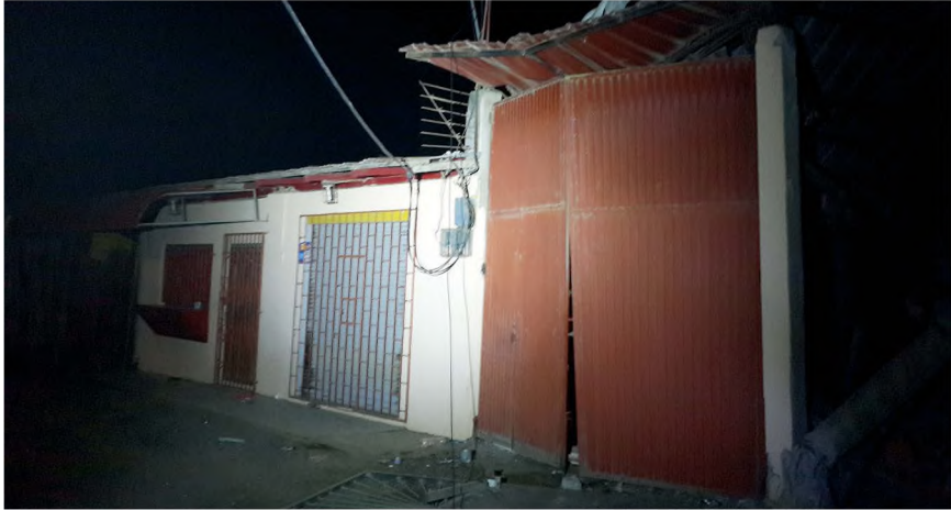
Figura 5.5.28 Cubierta de garaje amenaza caer. Terremoto de Pedernales, Ecuador 2016.
