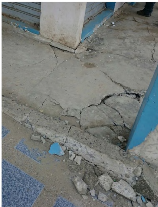
Figura 5.5.12 Hundimiento de cimentación. Muisne, Ecuador 2016.
