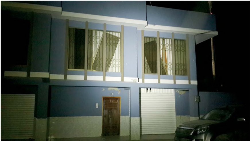
Figura 5.5.27 Ventanas corren riesgo de caer. Terremoto de Pedernales, Ecuador 2016.
