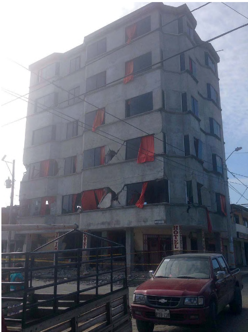
Figura 5.5.30 Revestimientos y mamposterías amenazan caer. Terremoto de Pedernales, Ecuador 2016.
