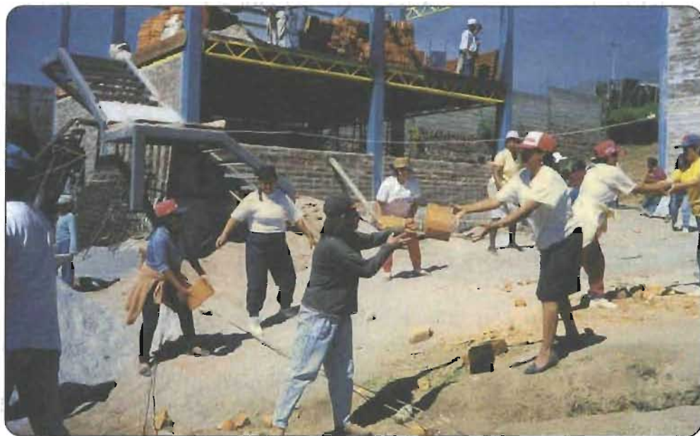
Participación de la comunidad en la construcción del Centro de Desarrollo Comunitario
