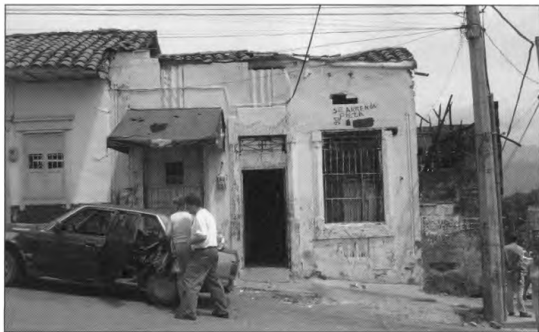
Fotografía 2 Fachada de inquilinato en un inmueble deteriorado
